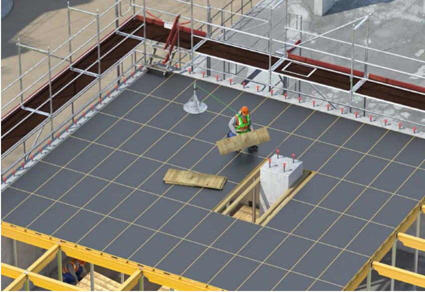
Abb. 7a Aufbau von Deckenschalungssystemen unter Verwendung von PSAG bei vorhandener Störstelle (Stützdurchbruch durch Deckenpaneele)
